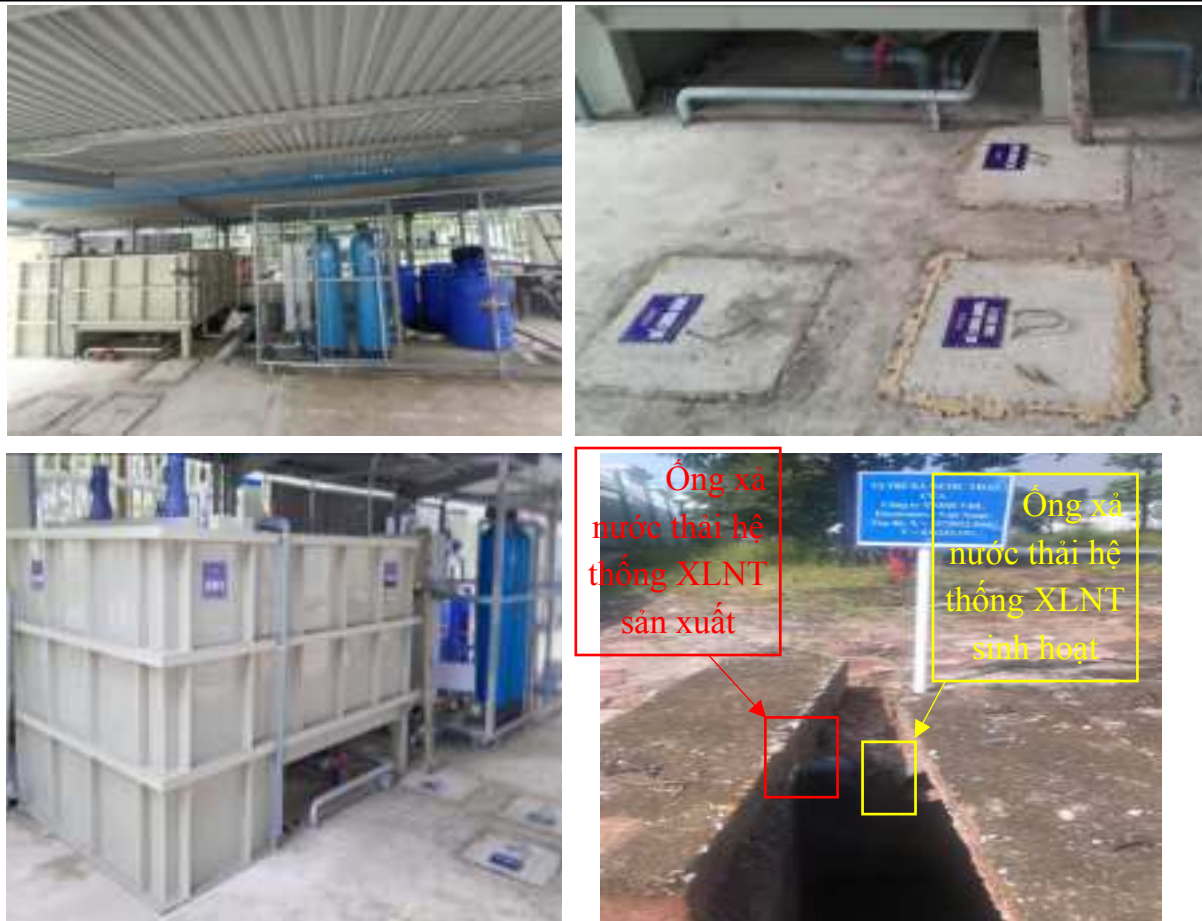
Hình 3.10. Hệ thống xử lý nước thải sản xuất công suất 20 m 3 /ngày đêm
