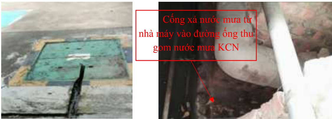
Hình 3.2. Hệ thống thu gom, thoát nước mưa
