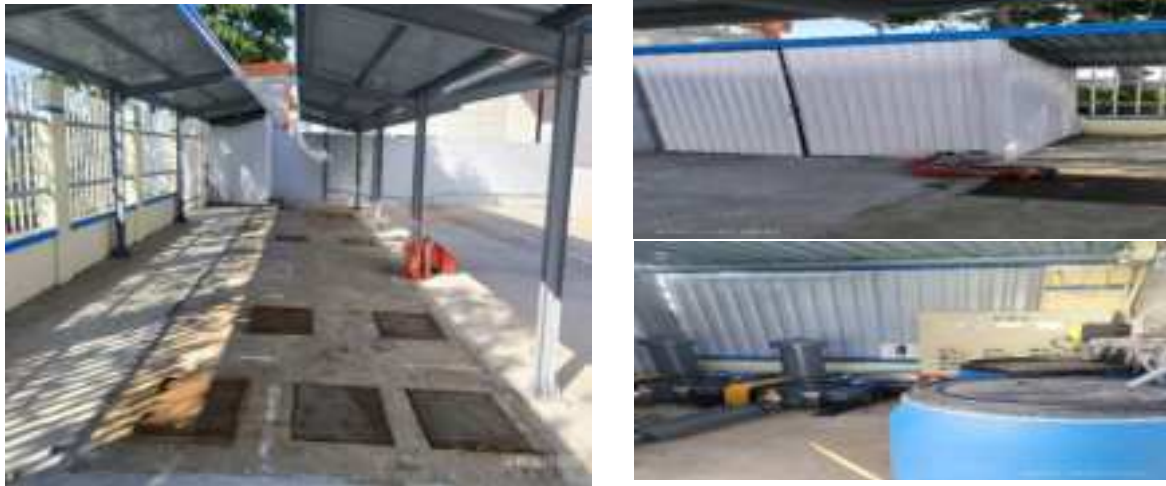
Hình 3.8. Hệ thống xử lý nước thải sinh hoạt công suất 30 m 3 /ngày đêm
