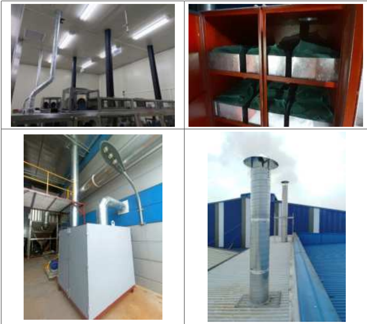
Hình 3.12. Hệ thống thu gom, xử lý khí thải công suất 3.000 m 3 /giờ (giai đoạn 1)
