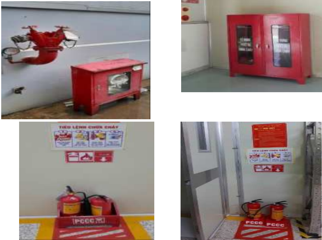
Hình 3.18. Ảnh phòng cháy chữa cháy
